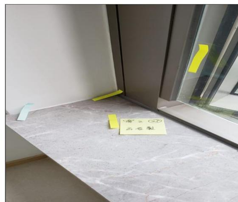
圖 25： 客房 2 窗台雲石裂
