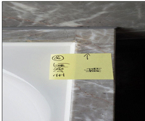
圖 80：浴缸旁雲石崩裂
